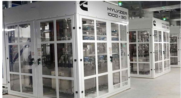
<20MW급 PEM 수전해 플랜트('21)> (캐나다, Air Liquide)
